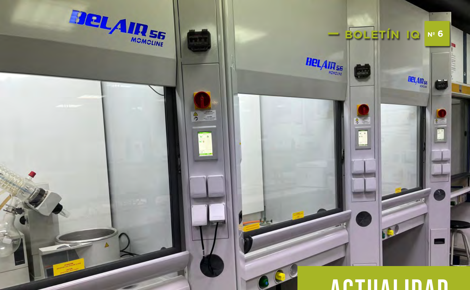
Fotografía: Campanas de extracción
